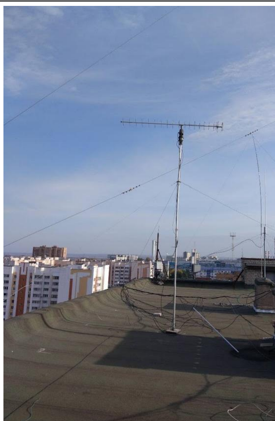
Рис. 3. Внешний вид наземной антенны прямого канала БиРЛК МКА «АИСТ-2Д», установленной на здании ПГУТИ
